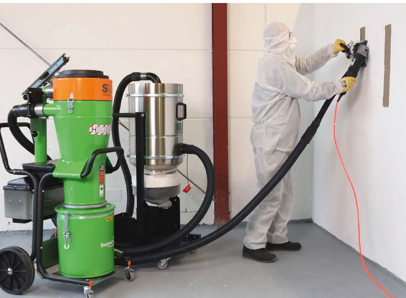
Das Maschinenpaket aus Vorabscheider mit Direktabsaugung und Wandfräse ermöglicht ein sicheres Abtragen von Putzen, Spachtelmassen und Fliesenklebern
