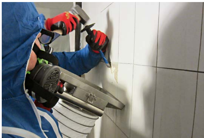
Händisches Entfernen der Fliesen mit Hammer und Meißel unter Absaugen mit dem Trichterabsaugsystem
