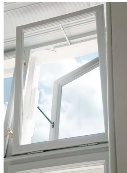
Eine geregelte Frischluftzufuhr durch sensorgesteuerte Fensterantriebe verbessert das Raumklima
