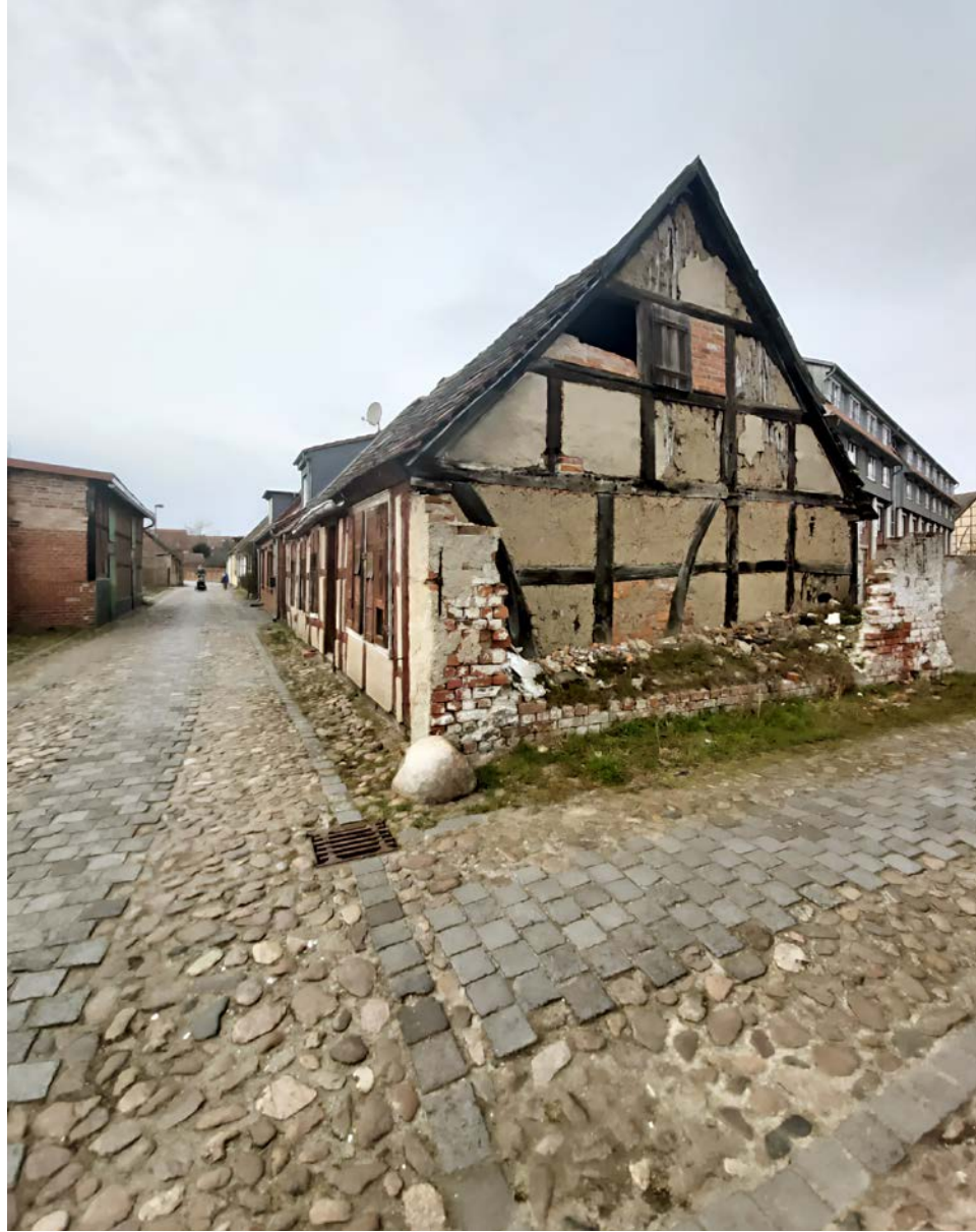
Ungünstige Grundrisse, die Lage direkt am Rinnstein und marode Bausubstanz: nur einige der zahlreichen Herausforderungen in vielen Kleinstädten wie hier am Beispiel von Seehausen in der Altmark
