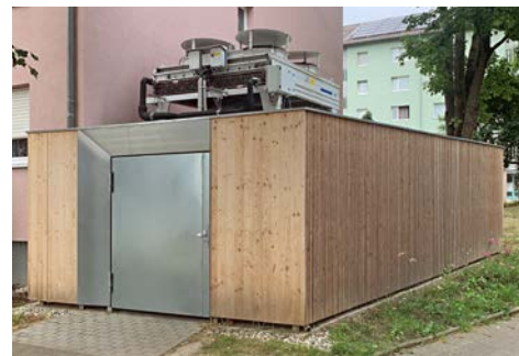
Wärmepumpen können im Mehrfamilienhausbestand in vielfältiger Art und Weise integriert werden
