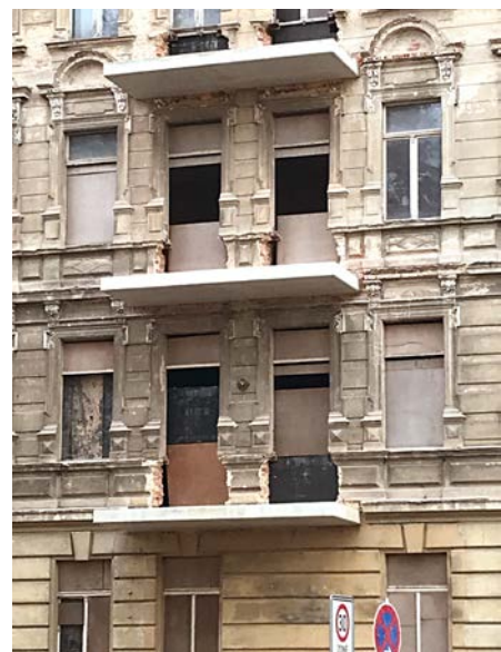
Zwischennutzungen können unter bestimmten Bedingungen auch eine Chance sein, vernachlässigte Wohnhäuser (hier in Görlitz) vor dem Abriss zu retten
