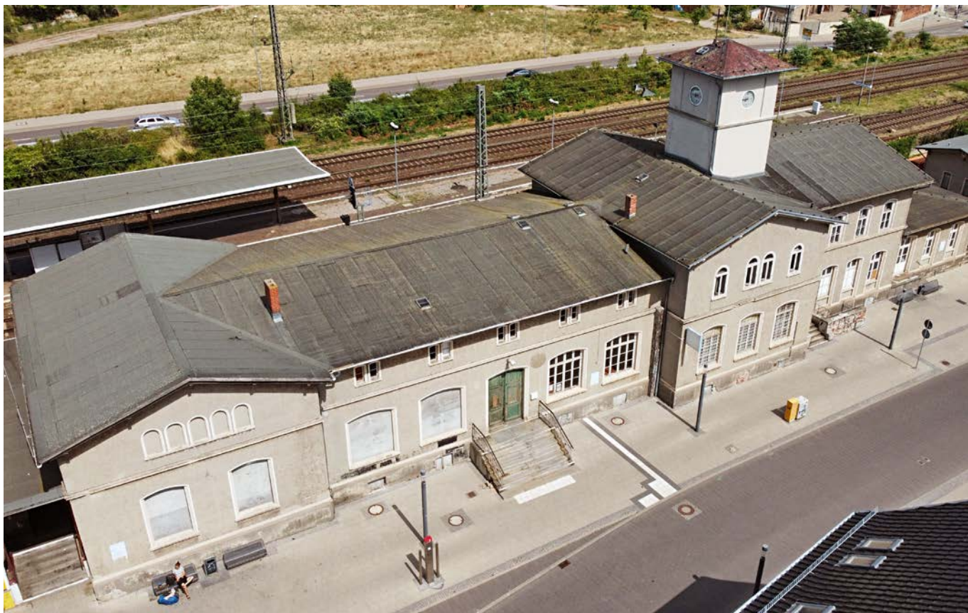
Das Bahnhofsgebäude von Schönebeck (Elbe) steht seit vielen Jahren leer. In der Mitte ist der Bahnmast zu sehen, dessen Nähe zum Gebäude die Sanierung behindert
