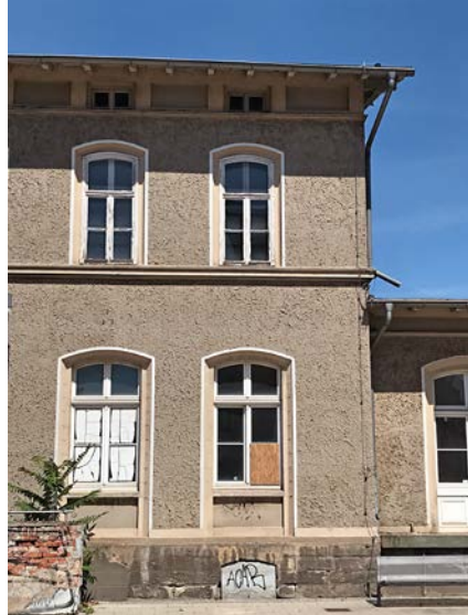
Trotz einzelner Schäden macht die Gebäudesubstanz einen recht soliden Eindruck
