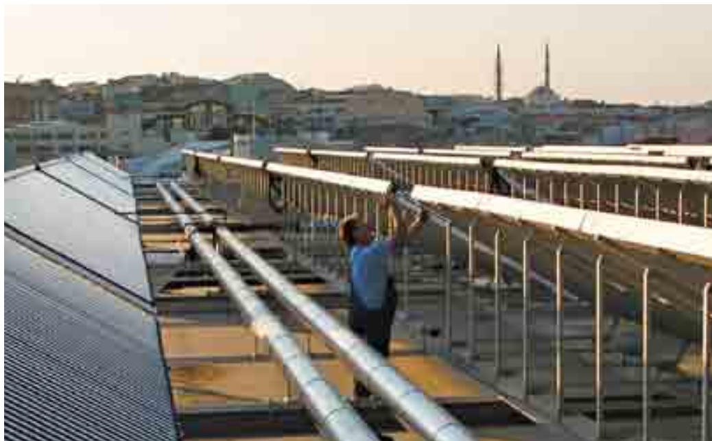
Solarthermie-Großanlage der Ritter-Gruppe.
